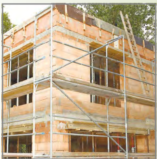
Früherkennung: Wenn Baumängel im Rahmen von Qualitätskontrollen frühzeitig entdeckt werden, lassen sie sich meist noch einfach beheben. Werden sie im Laufe des Baufortschritts überbaut, sind sie schwerer zu erkennen und oft noch schwerer zu beseitigen. Foto: DJD/Bauherren-Schutzbund/Getty Images/Manchan
