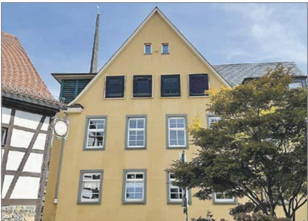
Schäden an den Betoneinfassungen festgestellt: Geeignete Sanierungslösungen werden erarbeitet; die erforderlichen Haushaltsmittel sollen im Haushalt 2027 eingeplant werden. Foto: Stadt OR
