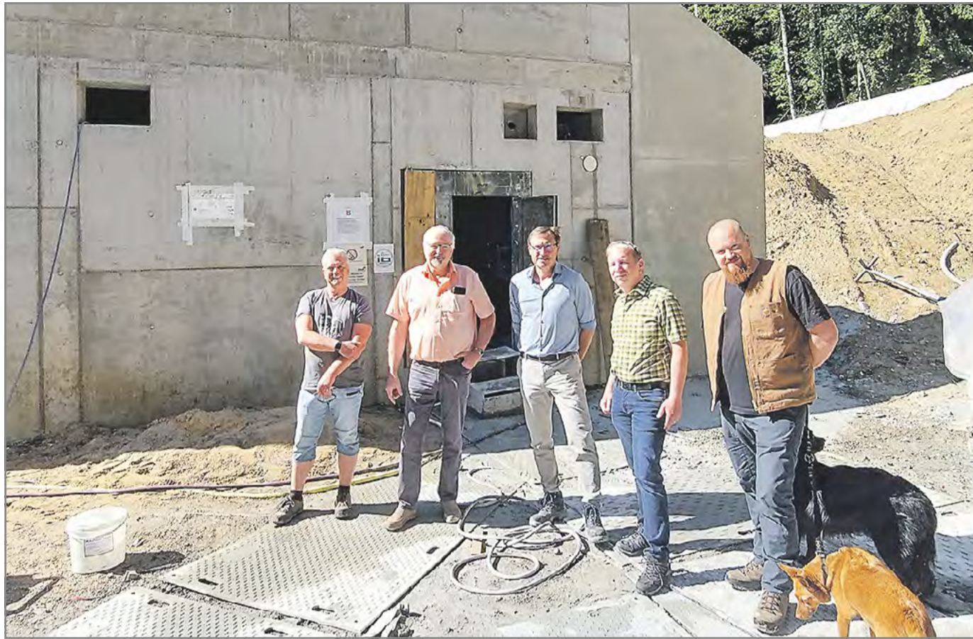
Haben die Zukunft im Blick: Mühltais Wasserversorgung soll auch in Trockenheits- und Dürreperioden sichergestellt sein. Vom Baufortschritt des neuen Hochbehälters am Kirchberg in Trautheim verschaffte sich jüngst Bürgermeister Willi Muth einen Eindruck. Unser Bild zeigt von links nach rechts Stephan Burschel (Weber-Ingenieure GmbH), Willi Muth, Ulrich Wollenschläger (Sachgebietsleiter Infrastruktur), Bauamtsleiter Karsten Kutschera und Revierförster Stefan Bock. Foto: Gemeinde Mühlthal
